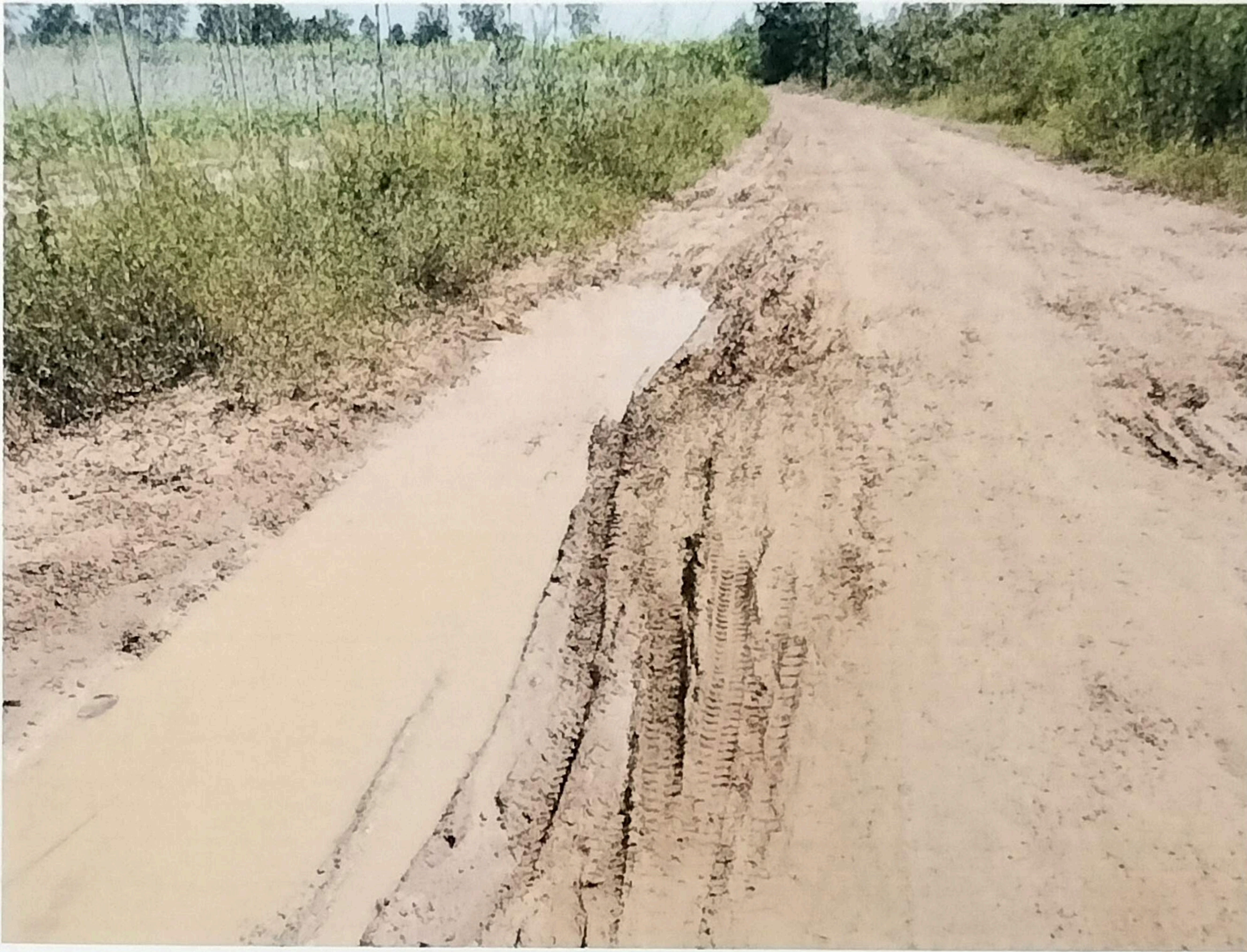
ภาพก่อนดำเนินการซ่อมแซม
